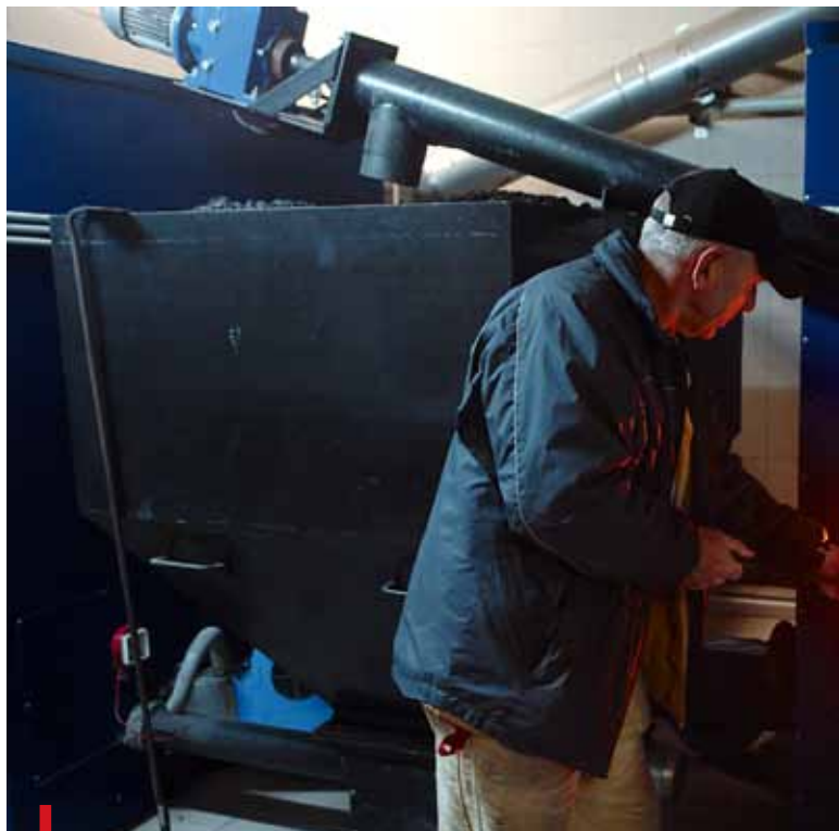
Józef Chmiela w kotłowni kościoła św. Jacka w Bytomiu
