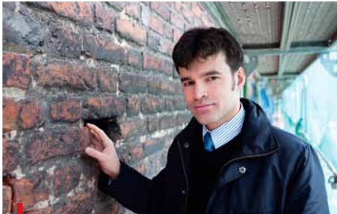
Po niektórych miejscach w murze nie zostało nawet „francuskie ciasto” – wskazuje konserwator Tomasz Korzeniowski
