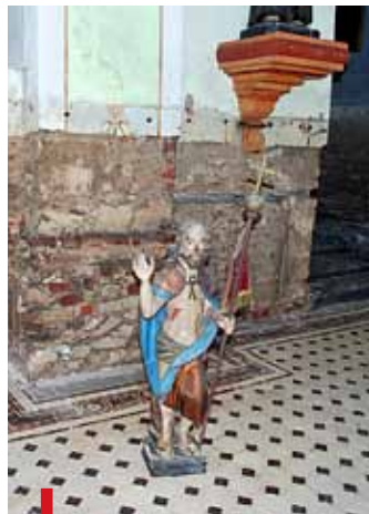
Kościół w Wilkowie również wymaga remontu: woda zniszczyła ściany i podłogi
