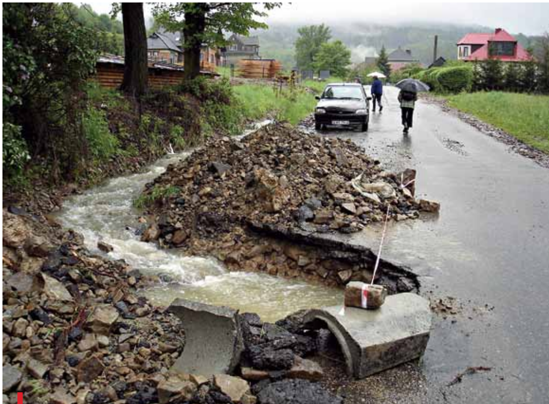
Osuwiska i podtopienia uszkodziły wiele małopolskich dróg, na przykład tę w Porębie
