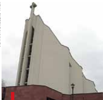
Dach kościoła Świętego Ducha, pokryty miedzianą blachą, stał się łakomym kąskiem dla złodziei
