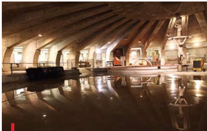
W dolnym kościele już wielokrotnie odprawiano Msze św. Ale regularne celebry będą mogły się tu odbywać dopiero po uszczelnieniu stropów
