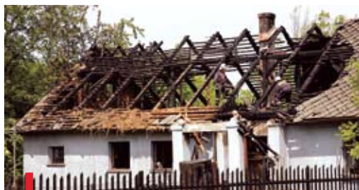
Budynek w Czańcu po pożarze
