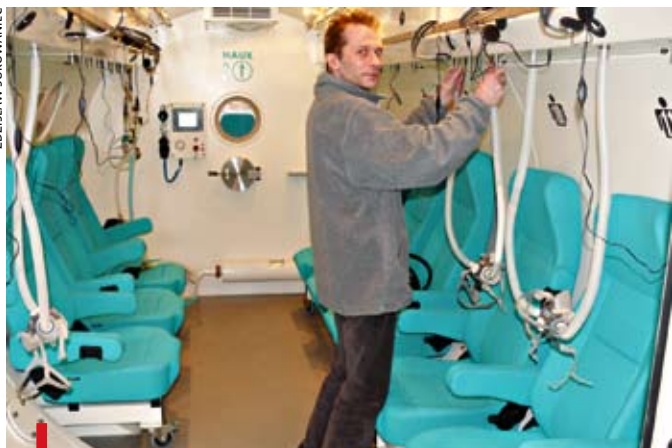
Wnętrze komory zainstalowanej w szpitalu w Stalowej Woli
