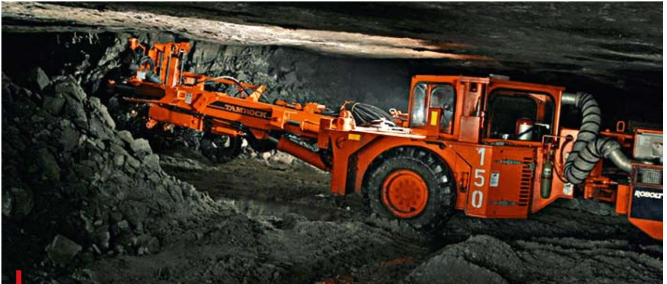
W złożu miedzi ten sprzęt wierce otwory na materiał wybuchowy. Potem ładowarki transportują urobek na taśmociąg, a ten wywozi go do dalszej obróbki
