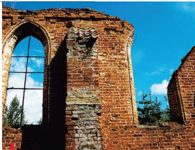
Gotyckie mury wymagają zabezpieczenia przed dewastacją
