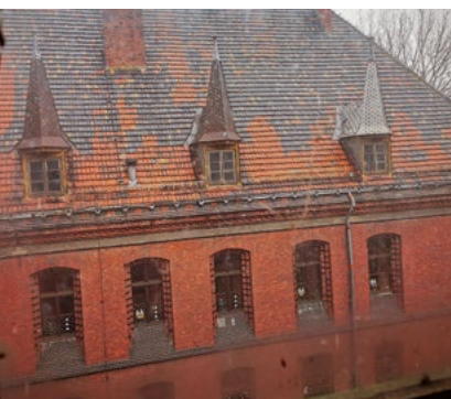
▲ Stan strychu i poszycia dachowego jest fatalny.
