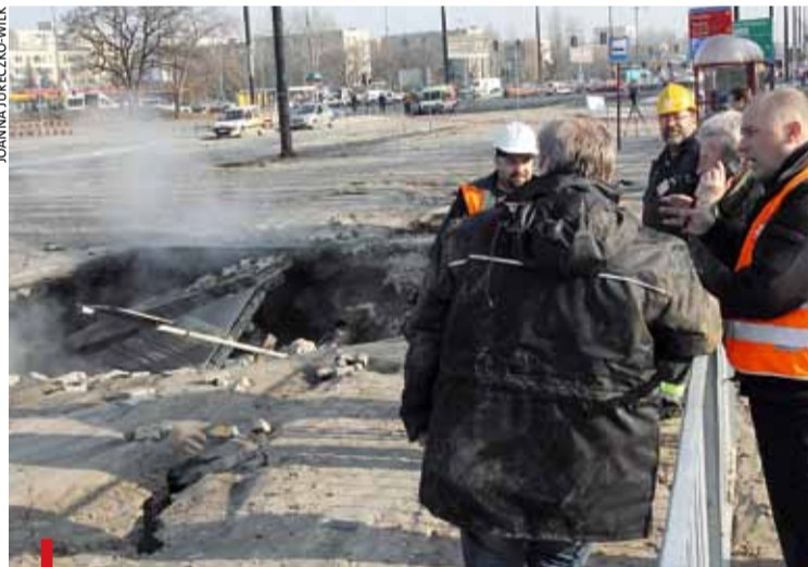
Woda zniszczyła część jezdni, chodnik i zbudowaną niedawno ścieżkę rowerową
