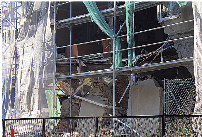
W zawalanej części budynek na pewno będzie wymagał rozbiórki
