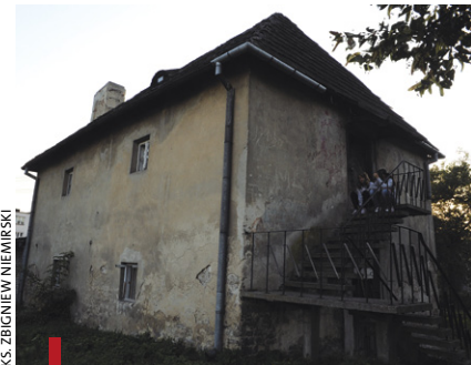
Obecnie nieużytkowany, budynek jest w dużej części uszkodzony
