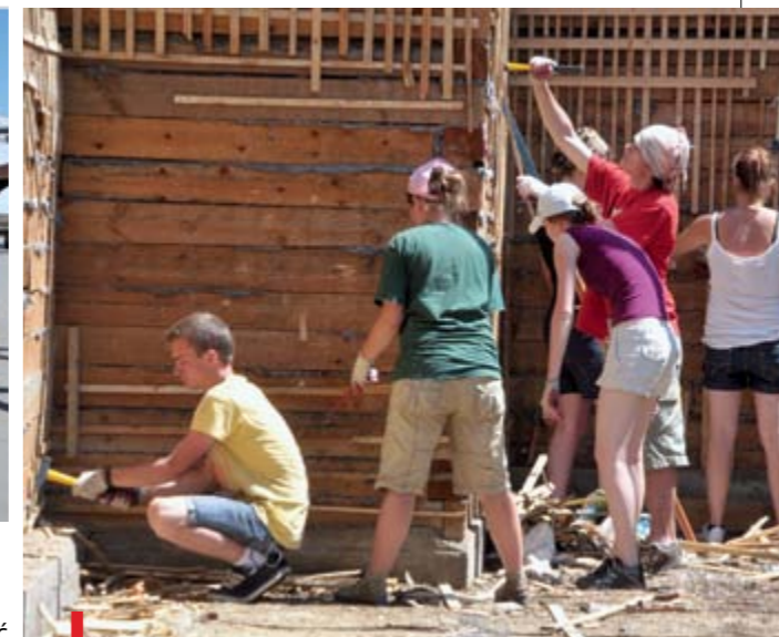
Jadąc do Mongolii, nikt z uczestników nie miał doświadczenia budowlanego. To nie przeszkadzało w wykonywaniu nawet najtrudniejszych prac
