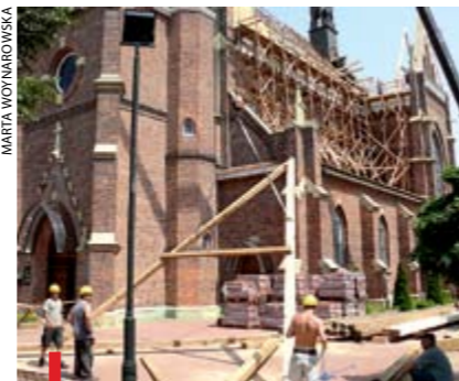
Prace przy wymianie dachu na kościele Matki Bożej Szkaplerznej w Stalowej Woli
