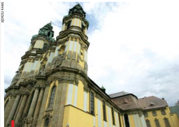
Na Wielki Odpust Krzeszowski mają być już zdjęte rusztowania z frontowej ściany bazyliki mniejszej
