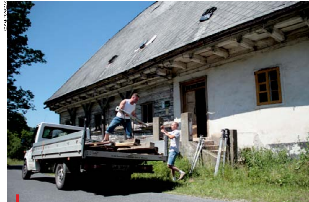
Po trzech latach czekania pod karczmę przysłupową podjechał pierwszy samochód firmy remontowej. Ale żeby plan udał się w całości, potrzebne będą dodatkowe pieniądze
